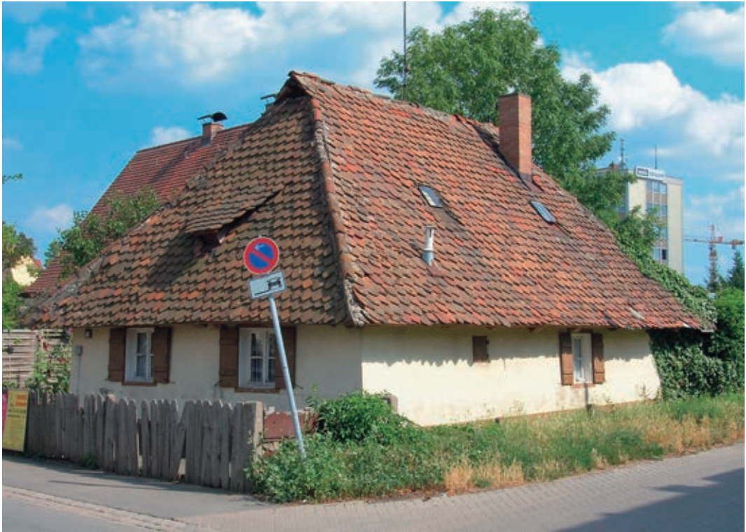
26 Großreuther Straße 98. Unübersehbar die Schäden in der Dach- deckung. Abmessungen: Länge 10,20m, Breite 6,10m, Höhe 5,80m. Alle Maße sind zirka Angaben. (Aufnahme vom Juli 2006)
