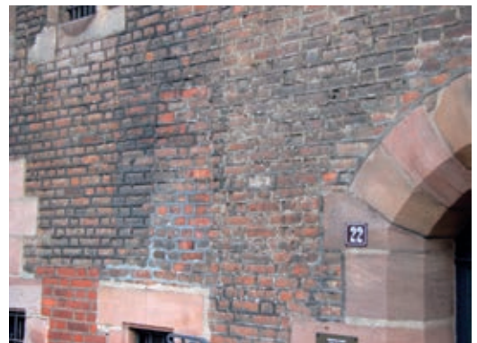
5 Heilig-Geist Spital, Nordseite Spitalgebäude – die 1939 rekonstruierten Bandfugen sind dort heute noch zu sehen.
