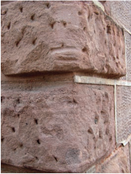
15 Hammerwerk in Nürnberg-Katzwang – Fugendetail im Bereich der Eckquaderung. Unten sieht man die „Aus-zwicklung“ der realen Fuge mit Ziegelresten.
