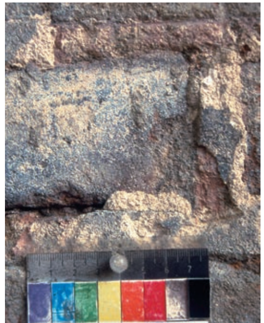
7 Reste von Bandfugen im Detail – Befundfoto am Mauerwerk des Gebäudes Füll 6.
