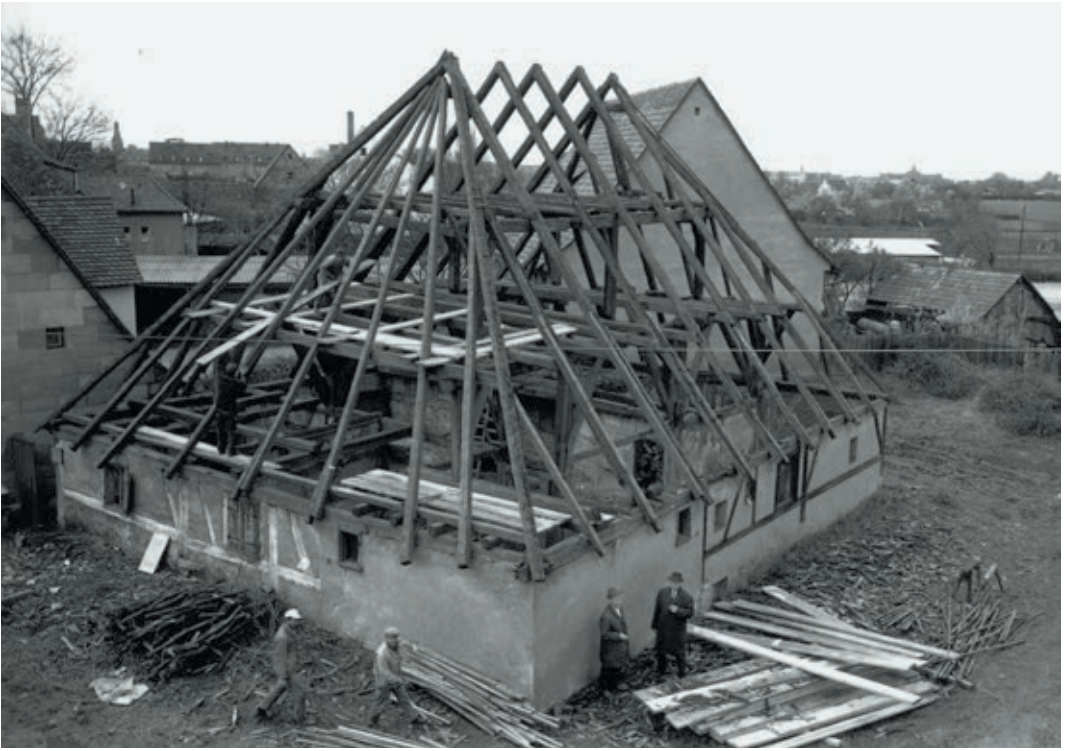
14 Die Abtragungen des Schwedenhauses Äußere Bucher Straße 33 ist im vollen Gange. Aufnahme vom 20. April 1966.
