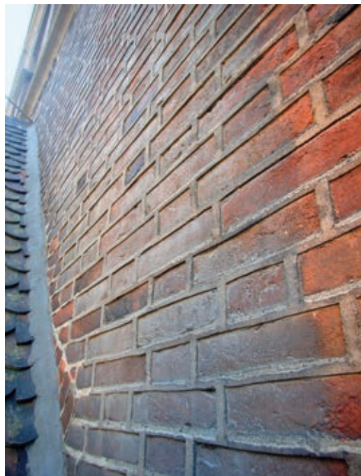
22 Bandfugen neben dem Dachbereich des Westportals an der Antoniuskirche.
