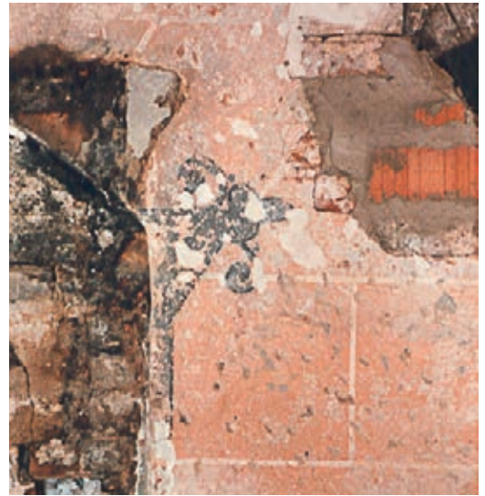
6 Auch die Quadermalerei in der Weißerbergasse 26 beschränkt sich auf die Gefache und zieht sich nicht flächig über die Wand.
