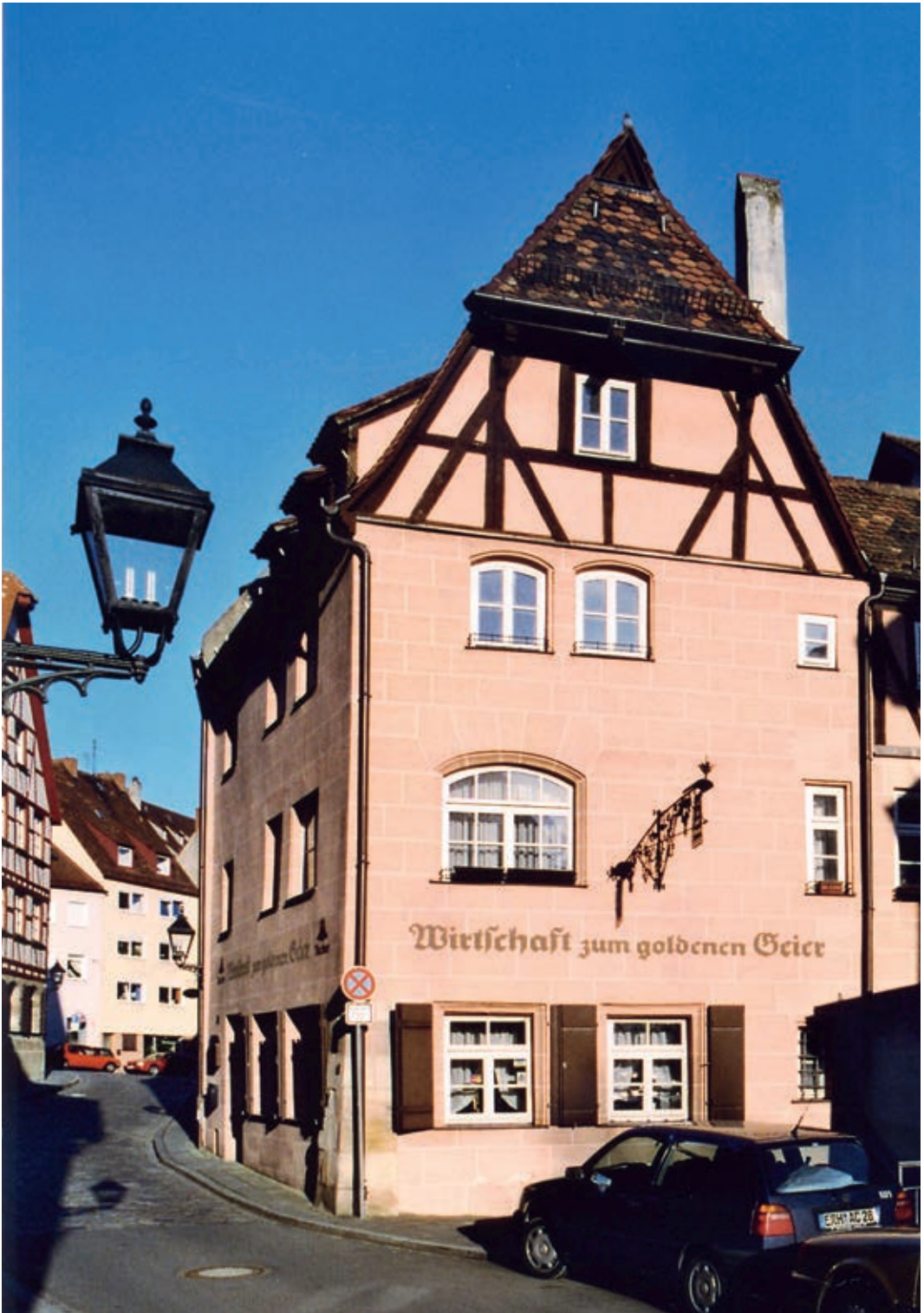
13 Nach Abnahme des Putzes kam das bauzeitlich verblattete Fachwerk im Giebelbereich zum Vorschein.
