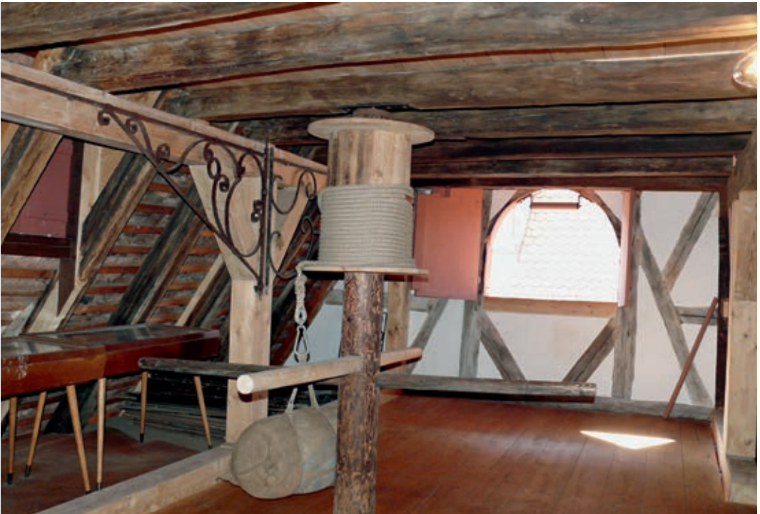
100 Der wieder funktionsfähige Aufzugsgöpel im 3. DG
