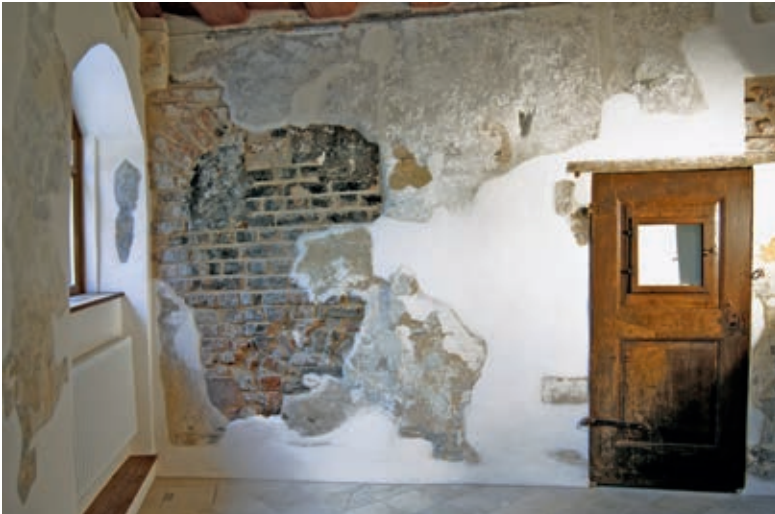
23 An der Wand sind Reste der ehemaligen Badstube zu sehen, die Türe führt in den ursprünglichen Heizraum.
