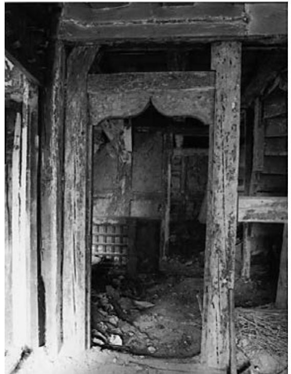
84 Beim Abschlagen des Putzes kam diese gotische Kiehbogentür zum Vorschein.
