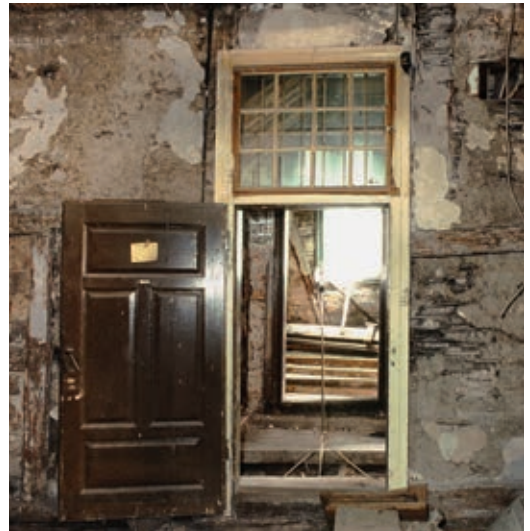
89 Im Inneren des Hauses zeigte sich das wahre Ausmaß des Verfalls.
