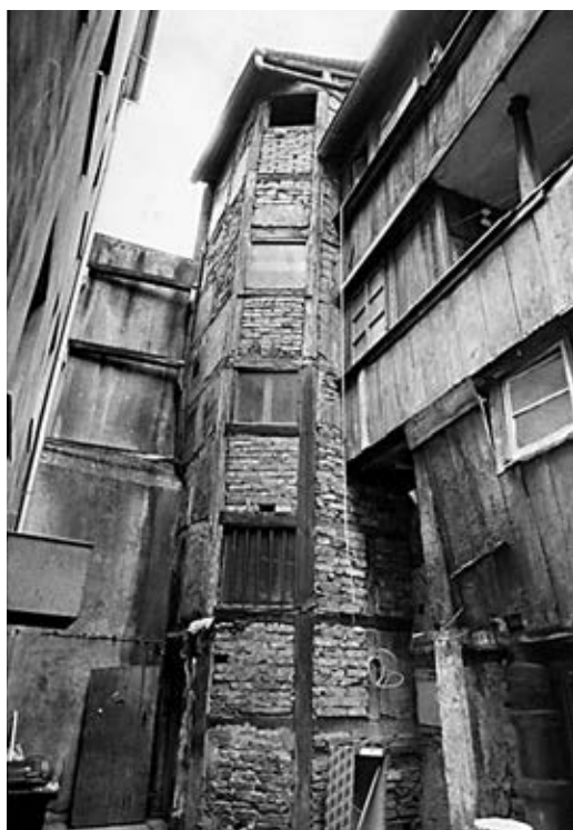
71 Der baufällige Treppenturm musste abgebrochen und neu errichtet werden.
