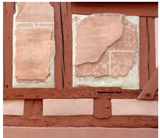
57 Einige unverändert erhaltene Gefache dokumentieren ältere Putze und Farbfassungen.
