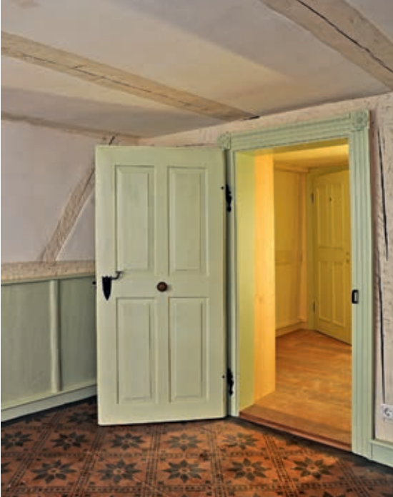
65 Im 1. OG war es in einem Zimmer möglich, die Schablonenmalerei auf dem Fußboden komplett zu restaurieren.
