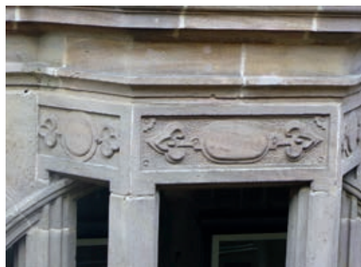
3 Fensterstürze von 1958/59. Der kleine Fenstersturz rückt mit seinem Ornament direkt an die Fassade.
