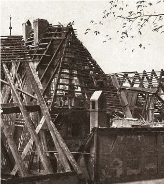
17 Obere Schmiedgasse 54/56 Blick in das bei einem Luftangriff abgedeckte Dach. Deutlich sind die beiden Gratsparren und die radialverlaufenden Walm- sparren zu sehen. Unter- halb der dreiecksförmigen Öffnung liegen die Walm sparren auf einem waagrechten Balken, dem sogenannten Hahnenbalken, auf. Foto 1942
