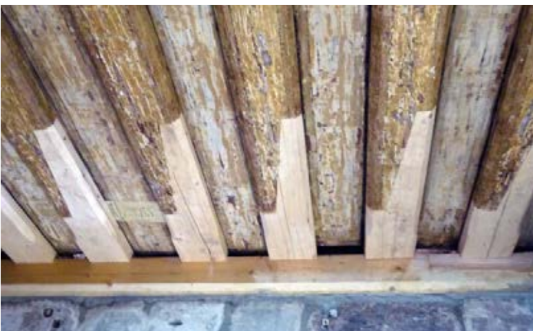
27 Stauwärme bewirkte auf der Westseite, zum heutigen Parkhaus hin, dass die Holzkonstruktion gravierenden Schaden nahm.
