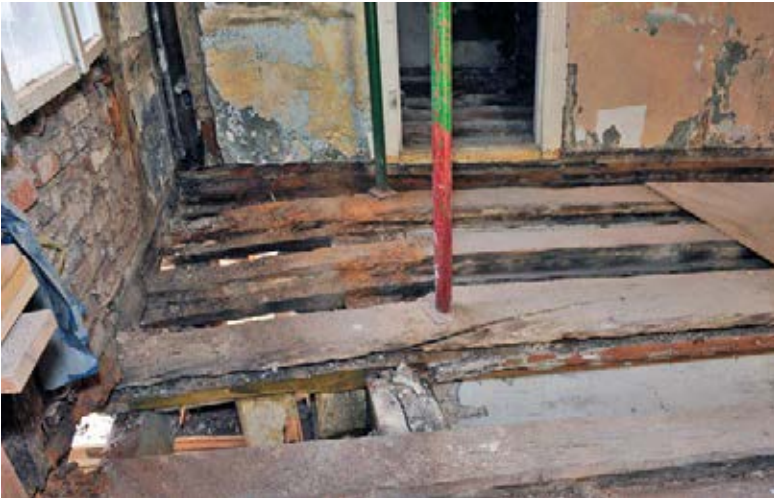
25 Jahrzehntelange Vernachlässigung führte zu dem bedrohlichen Zustand des alten Gerberhauses. Links, unter den durchgebogenen Balken der Auskragung, der Hof.
