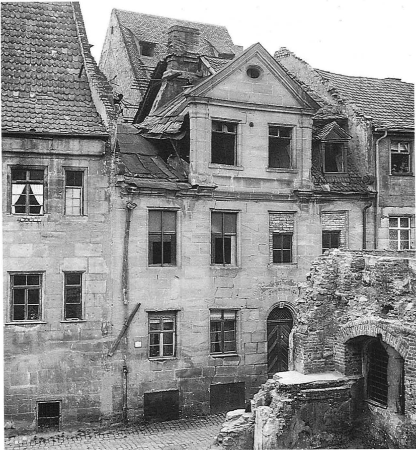
5 Agnesgasse 9. Nur Dachschäden (beachtlich der schräg gemauerte Kamin!). Aufnahme 1951; Abriß 1952. Bild 6 zeigt die seither bestehende Lücke zwischen den Seitenwänden der beiden erhaltenen Nachbarhäuser.
