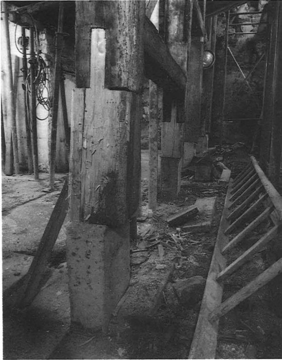
Die beiden westlichen Erdgeschoßpfosten werden an ihrem unteren Ende mit gesundem Holz angeschuht und auf Betonsockel gestellt. Links das Hausinnere, rechts der eingeringelte Hof.
