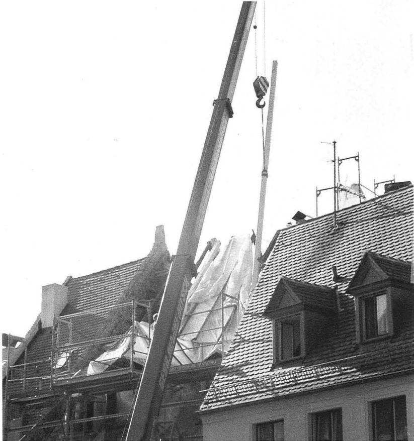
8 Endlich wieder Leben in der Bergstraße 23: Einbau der elf Meter langen Leimbinder als Träger des Hängewerks aus Stahlstäben (Aufnahme am 28. September 1992).
