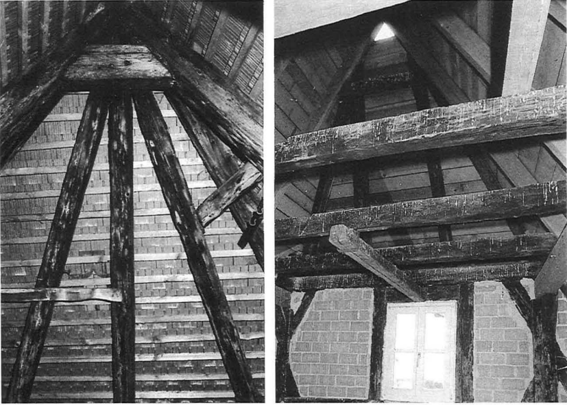
5/6 Links: Peter-Vischer-Straße 1 (Walmsparren in unveränderter Lage; das Windloch aber geschlossen). Rechts: Geiersberg II (die Radialsparren später durch parallele Walmsparren ersetzt, der alte Hahnenbalken verschwunden, das Windloch jedoch offengehalten). Über dem Fenster verläuft der Aufzugsbalken.
